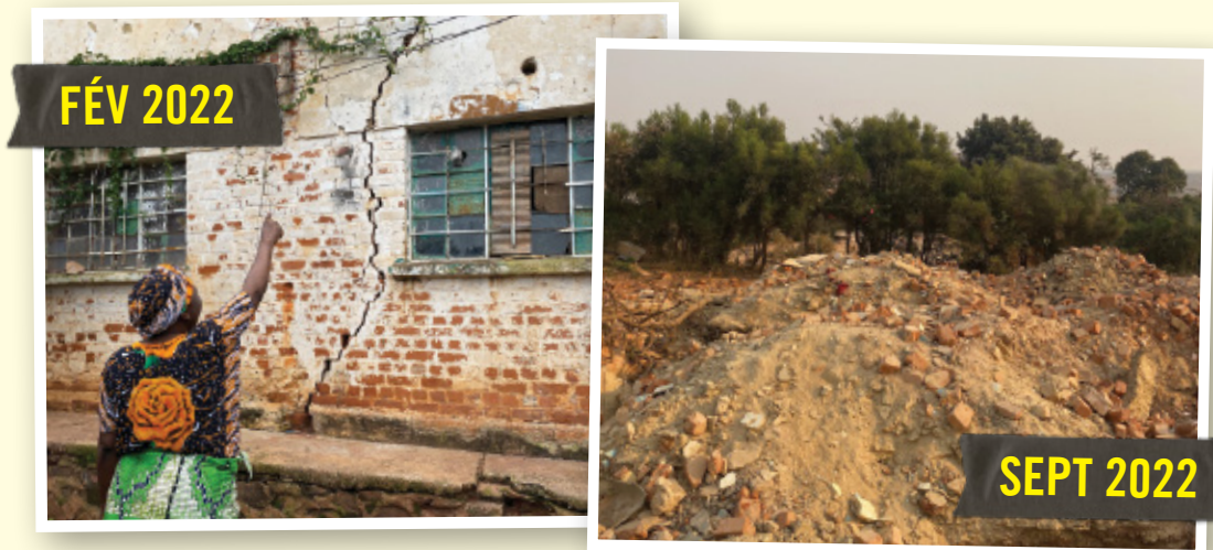
↑ Cécile Isaka montrant une fissure dans sa maison provoquée par les activités de la mine de cuivre et de cobalt exploitée par COMMUS, février 2022 (à gauche) ; ruines de la maison de Cécile Isaka, septembre 2022 (à droite). © Amnesty International (photo : Jean-Mobert Senga)
