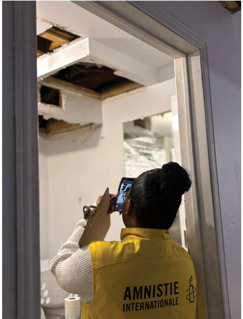
Trous dans un plafond d'une maison à Manawan
