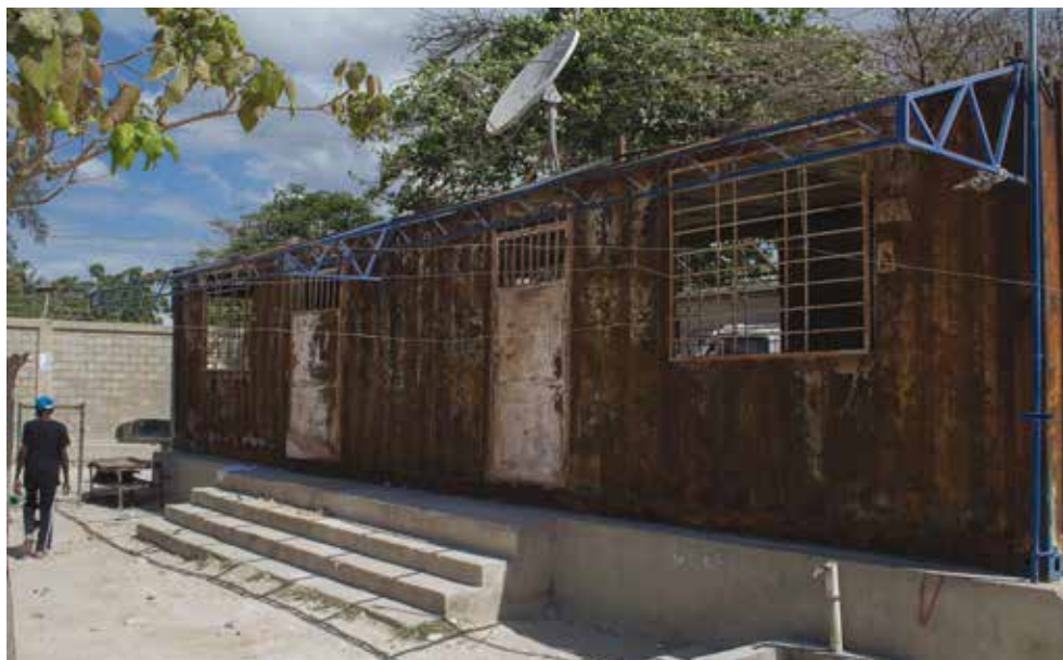
© Bureau des services haïtiens de l'immigration à Anses-à-Pitres, avril 2016. Le bâtiment, visé par un incendie volontaire début 2016, n'a pas été remis en état. Le représentant des services était assis dans la rue quand Amnesty International s'est rendue à Anse-à-Pitres. ©AmnestyInternational
