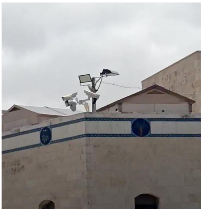
Caméras, projecteurs et appareils de détection de bruits installés sur un toit en secteur H2. © Amnesty International
