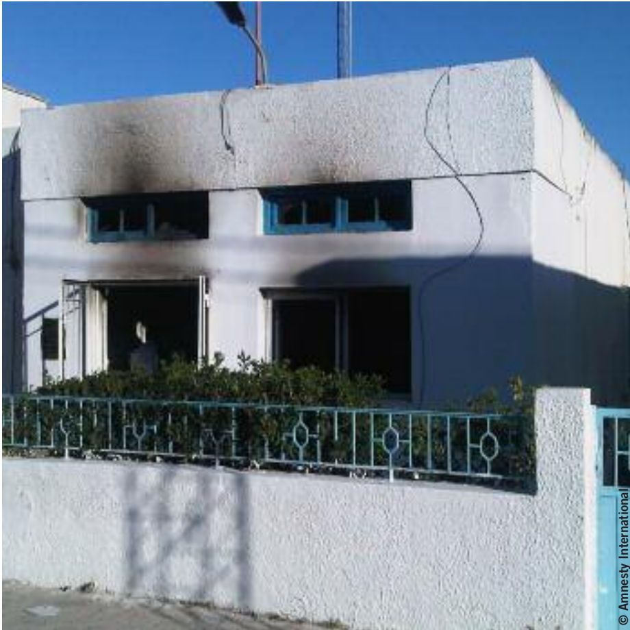
Poste de police incendié à Ariana, au nord de Tunis, janvier 2011
